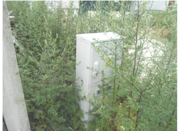
Fot. 20. Widok skrzynki ZK przy granicy działki
